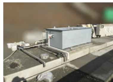
高速道路盛土浸出水処理 (愛知県 2015年) 吸着ろ過槽によるヒ素吸着処理 (300L/h)
