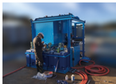
除染現場の小型排水処理プラント (福島県 2015年) 凝集沈殿による放射性物質処理(3.0m 3 /h)
