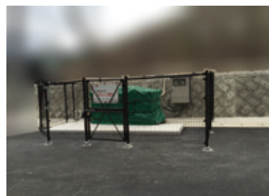
高速道路盛土浸出水処理 (愛知県 2015年) 無電源吸着ろ過槽によるヒ素吸着処 (100L/h)
