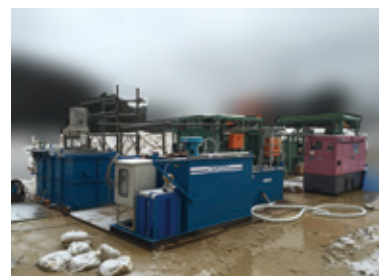
高速道路工事における排水対策 (島根県 2016年) 凝集沈殿によるフッ素・カドミウム・SS・ pH処理 (30m 3 /h)
