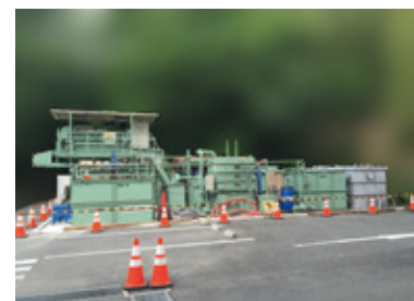
建築工事現場の水処理プラント (神奈川県 2015年) 曝気・凝集沈殿によるVOCs・ヒ素吸着処理 (10m 3 /h)
