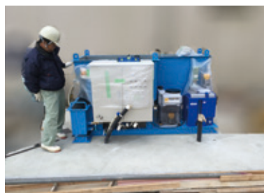
解体工事現場の小型排水処理プラント (山口県 2015年) 凝集沈殿によるSS処理(1.5m 3 /h)
